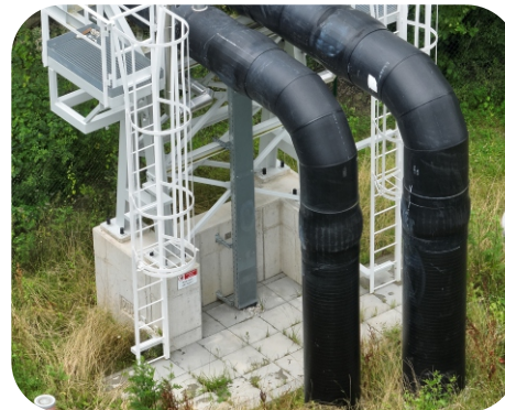
Teplý napáječ Elektrárna Temelín - České Budějovice
