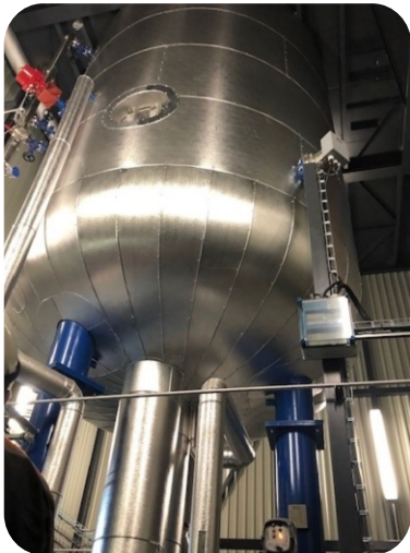
Záložní zdroj tepla – elektrokotelna v Elektrárně Poříčí
