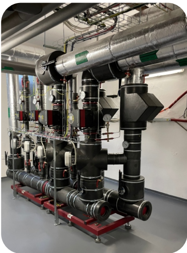
Výměníková stanice pára-voda v areálu EUC Polikliniky
